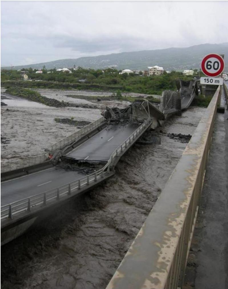
(Effondrement du Pont de la rivière Saint-Etienne par affouillement)
